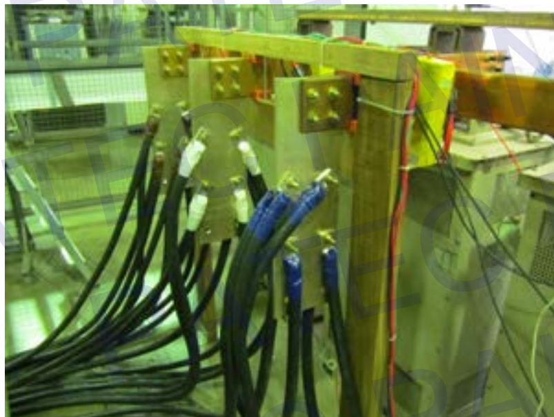
Foto 2 Cabos de conexão da fonte à entrada do painel
